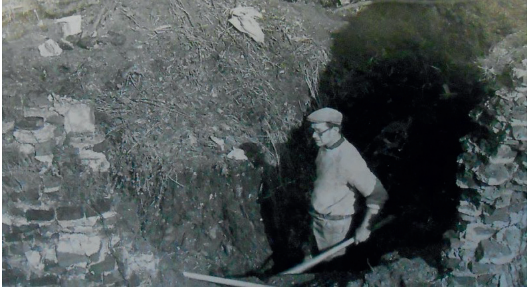
Afb. 2. Graafwerken langs de muren tijdens de restauratiecampagne 1972-1978 (Archief- & Documentatiecentrum Heemkring De Hellebaard). Hier is te zien dat de muren van de burcht (zowel binnen- als buitenzijde) deels reeds vrij gelegd zijn bij de restauraties uit de jaren '70 en dat de zones langs de muren minstens deels geroerd zijn.
