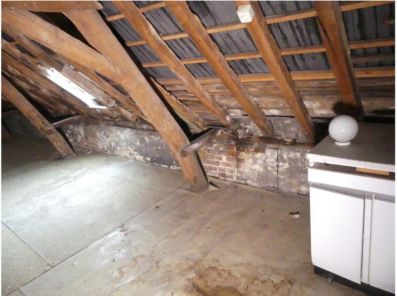
Foto 6: Kappoten met blokkelen verankerd aan muurplaat in haaks ingeplante achterbouw (huisnummer 5, Peperstraat)
