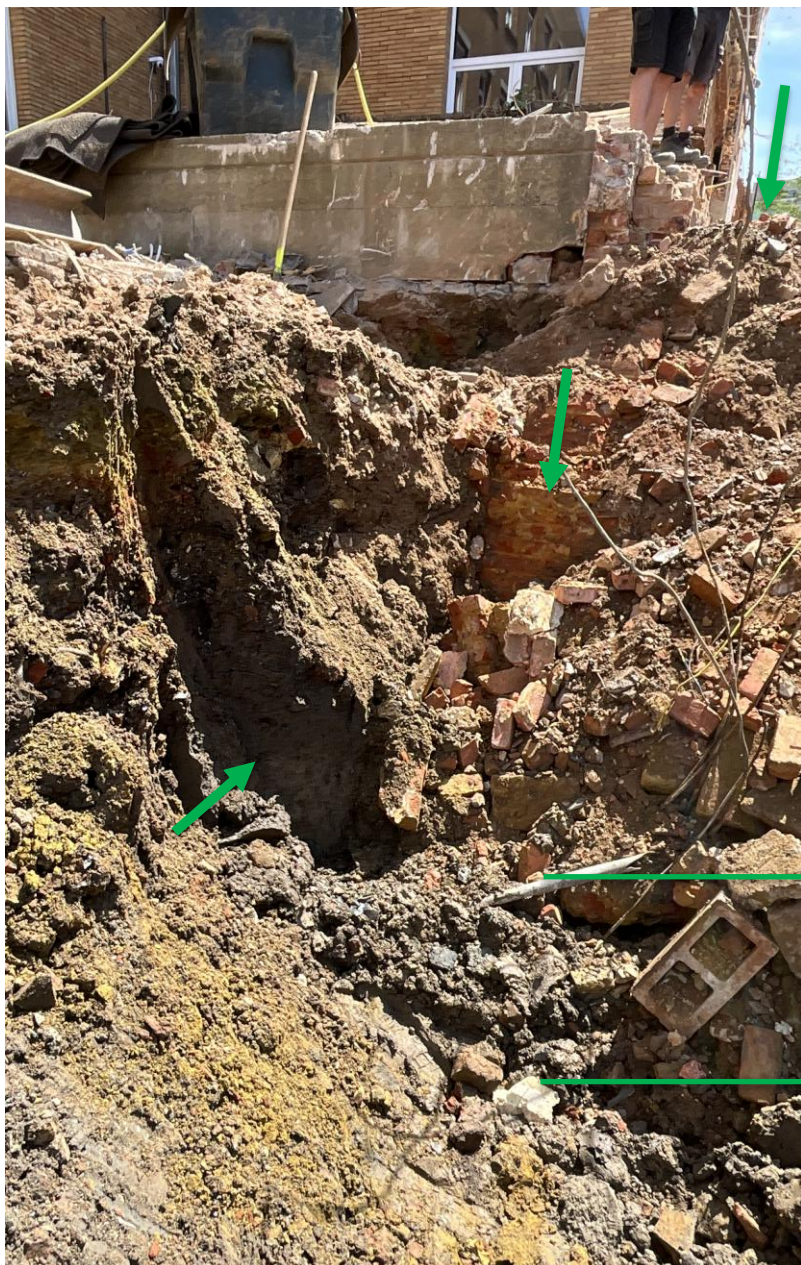
Foto 40: Opvolging van een testput bij de plaatselijke uitbraak van de keldermuur en -vloer van de annexe. De bovenste groene pijl geeft de opvulling van de kelder van de annexe weer. De middelste groene pijl is de keldermuur. De linkse groene pijl is vermoedelijke grens tussen de ongestoorde bodem met de archeologische stratigrafie die zich erboven bevindt. De twee horizontale groene lijnen duiden de gewapende vloeropbouw van de kelder aan. Ook onder de vloeropbouw is de bodem geroerd.
