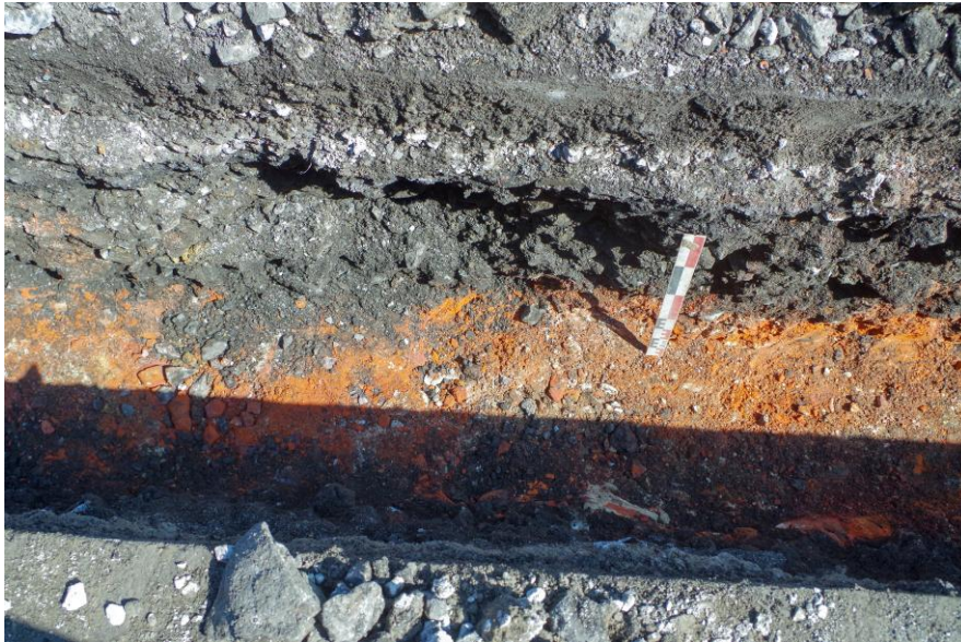
Foto 43: Opvolging van een van de nutsleidingen op de parking achter het stadhuis in 2019. Op de noordelijke grens van het huidige projectgebied gebeurde in 2019 een smalle afgraving tot een diepte van ca. -70 cm. Hierbij werd enkel de bestaande toestand en een puinpakket aangesneden.
