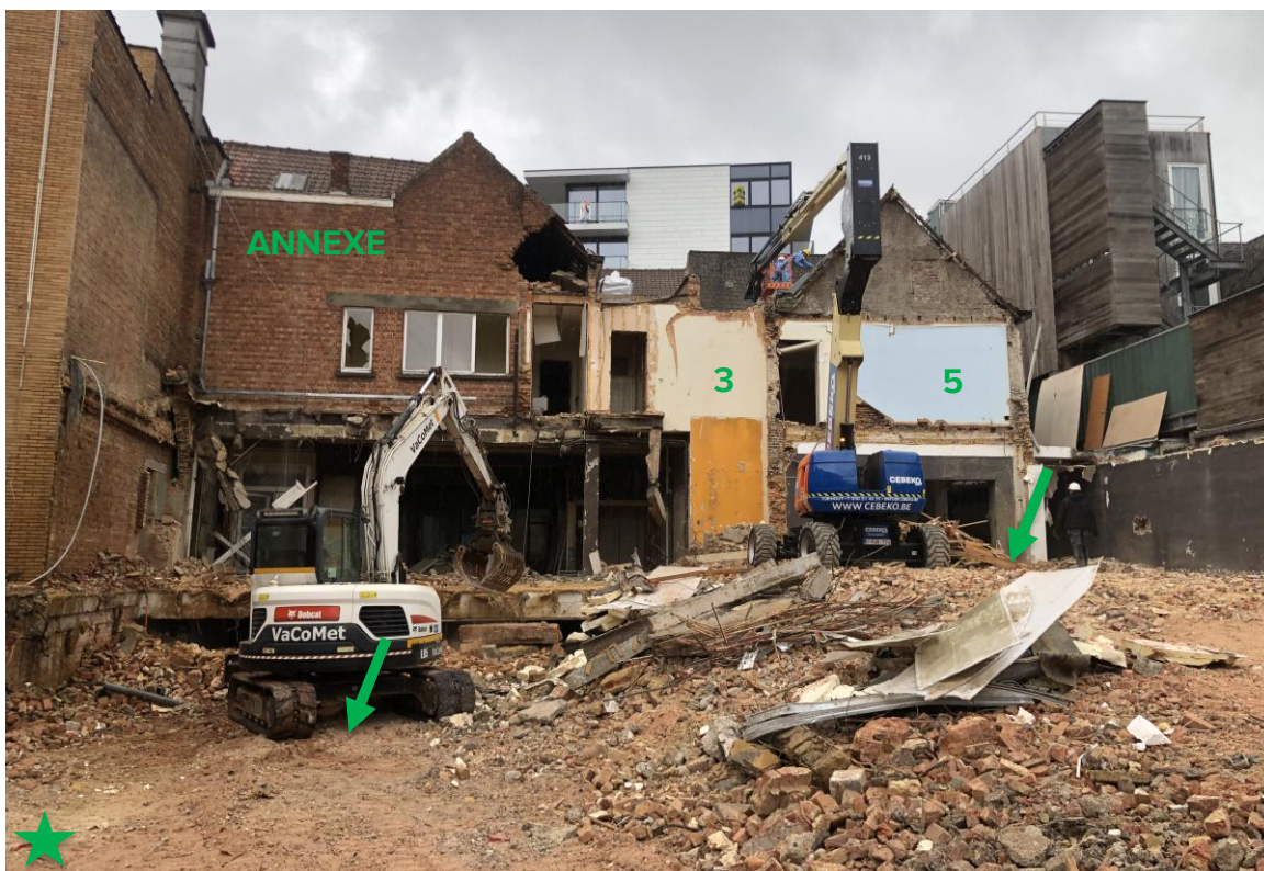
Foto 39: Zicht op de sloopwerken van de annexe, Peperstraat 3 en 5 net voor de aanvang van het proefsleuvenonderzoek. De rechtse groene pijl geeft het bestaande niveau aan waar proefsleuf 1 en 2 zich bevinden. De linkse groene pijl is de deels opgevulde kelder onder de annexe. De groene ster links onderaan geeft de locatie van Foto 40 weer.
