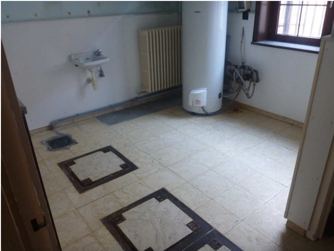
Figuur 22: foto van een ruimte binnen het gebouw met putdeksels en afvoerbuïs
