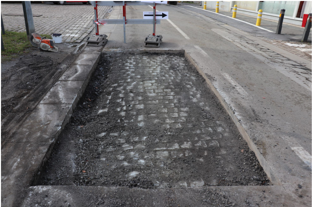
Figuur 11: Kasseien onder het asfalt in zone III.
