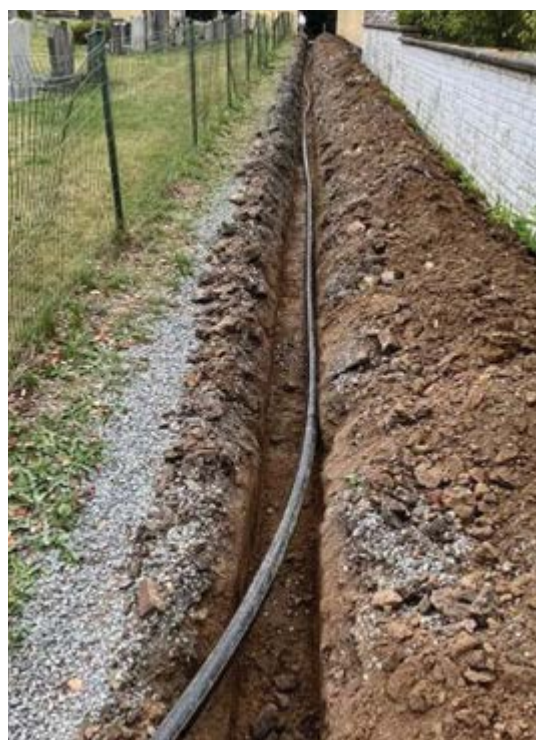
Afb. 15. Zicht vanuit het noorden op de aangelegde leidingsleuf in Zone II. Links onderaan het losse deksel dat in 2017 nog in gebruik was (zie Foto 1).
