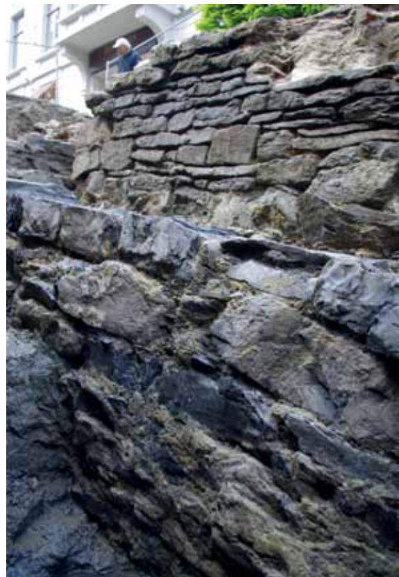
Afbeelding 23: De mortel geeft een aanwijzing over de wijze waarop de toren is gebouwd.
