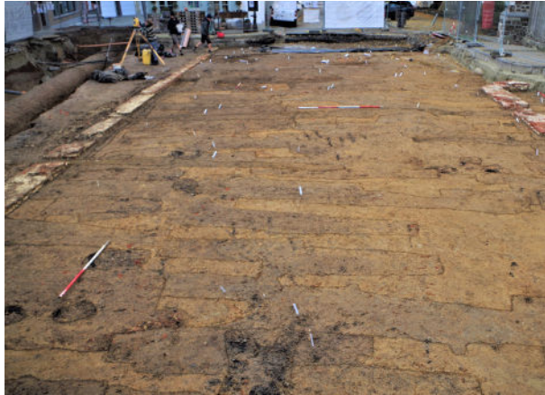
De bakstenen kerkhofmuur (links) met tal van rechthoekige grafkuilen (bruin) uitgegraven in de natuurlijke bodem (geel) op het Sint-Martensplein (SOLVA)
