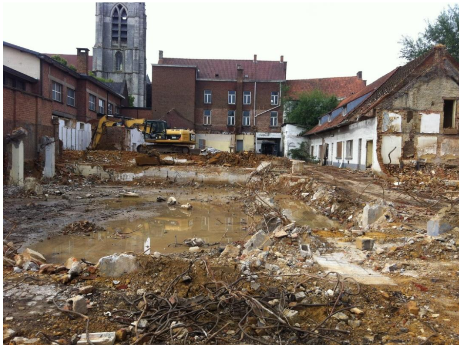
Figuur 2: zicht op de sloopwerken van de bovenbouw (04/07) met op de voorgrond de betonnen vloerplaat en pijlers van de voormalige filmzaal Familia
