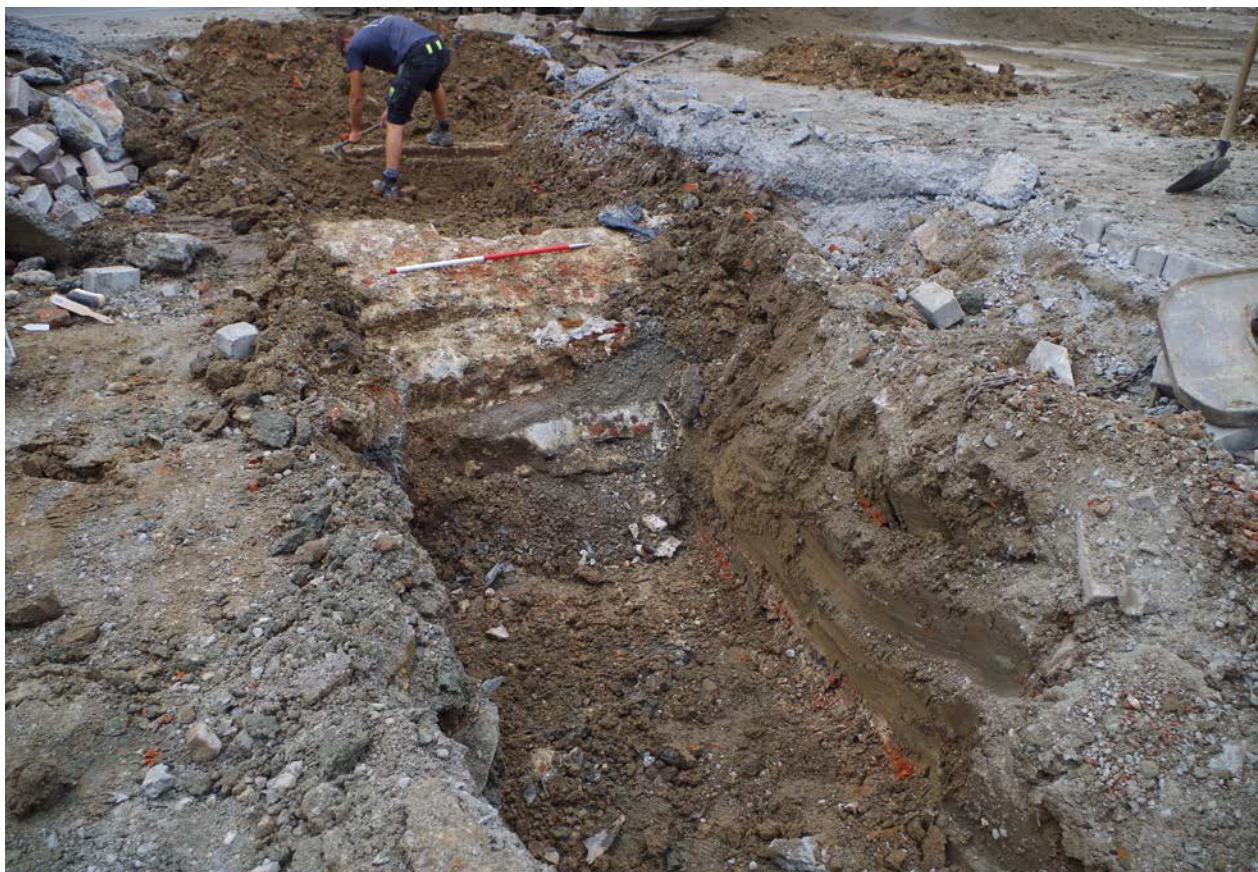
Figuur 45. Zicht op een stuk van de stadsmuur tijdens de werken. De muur bevindt zich vlak onder de pleinverharding.
