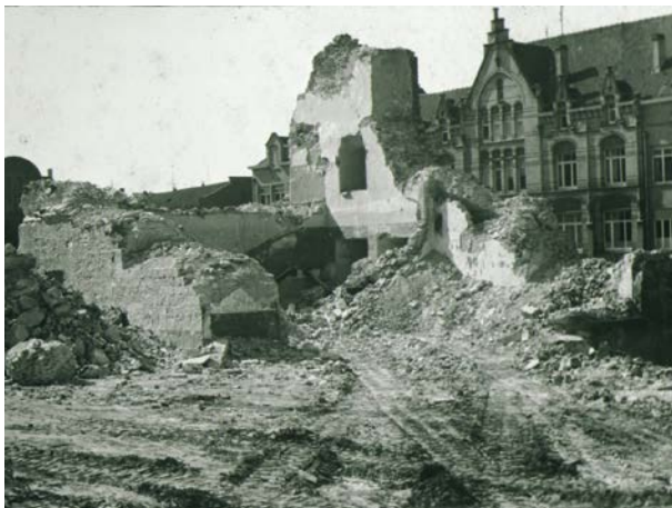
Foto 40. Zicht op het kasteel bij afbraak. Achteraan is het huidige Woonzorgcentrum H. Hart zichtbaar. De constructie die op deze foto wordt afgebroken is de grote toren. (Foto: Stadsarchief Oudenaarde, 1970_098_027_032).
