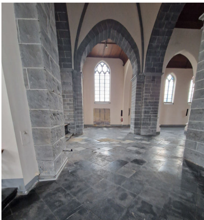
Foto 6. Zicht op de beschadigde vloer binnenin de kerk. ©SOLVA
