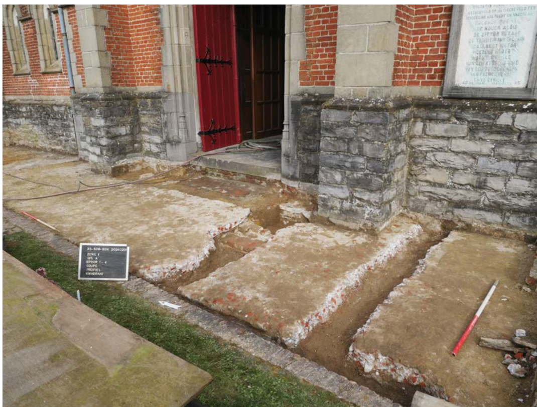
Afb. 7. Beperkte verdieping voor de twee rioolaansluitingen naar de nieuwe sanitaire ruimte binnen de kerk.
