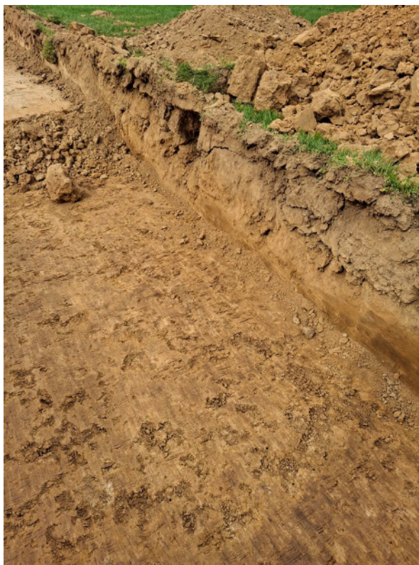
Figuur 4. Zicht op de extreem harde ondergrond ter hoogte van de voetbalterreinen.
