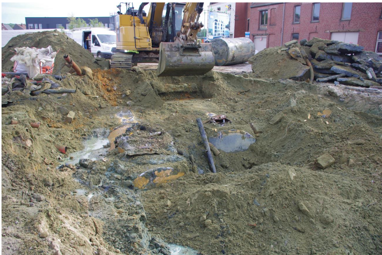
Figuur 38: Uitgraven van de brandstoftanks in het zuidelijk 'punt' van het onderzoeksterrein.
