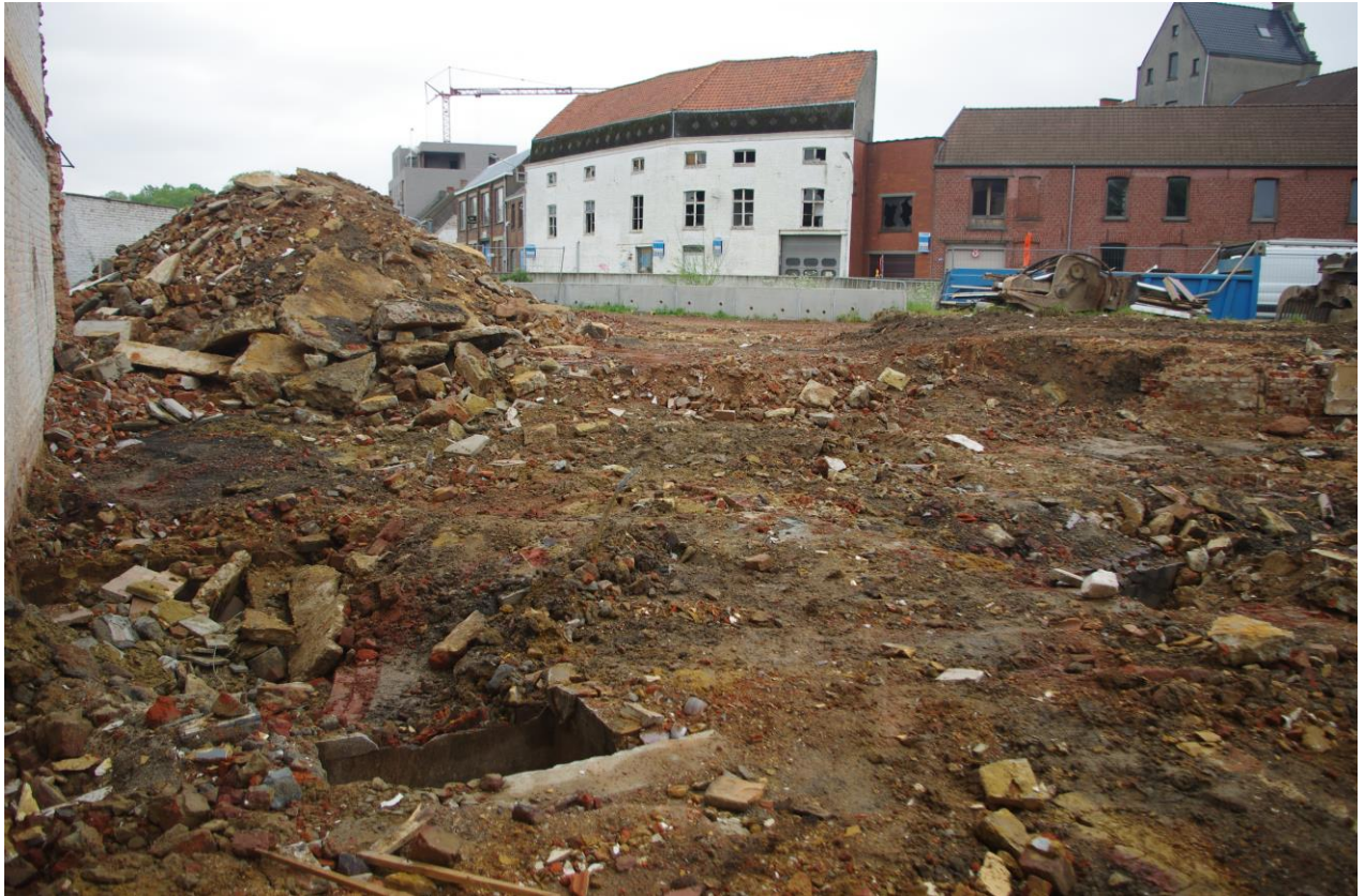
Figuur 44: Zone 1 met zicht op centraal gedeelte van het onderzoeksgebied. Er zijn tal van muren en regen-/beerputten te zien, die bij de bestaande toestand horen.
